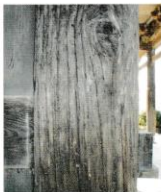
風食した木材(柱) 開善寺山門(川路) 室町時代初期 国指定重要文化財 飯田市内で一番古い建物で、約600年前の木材が使われています。
